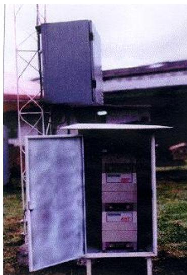
Figura No. 8. Estación Meteorológica - gabinete analizador- Estación Esc. Col. de Ingeniería
