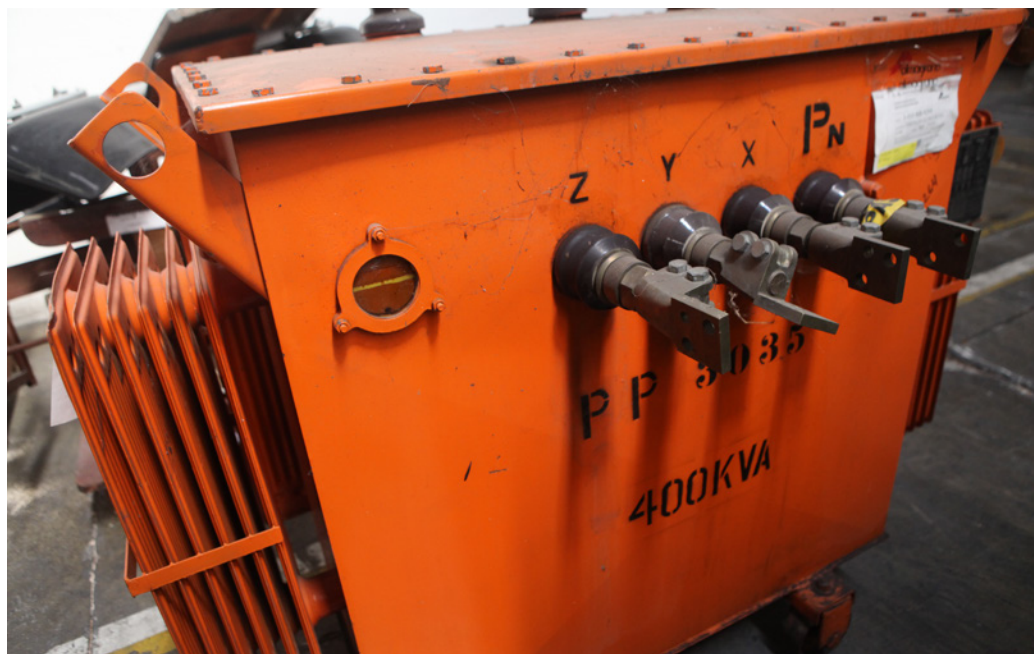
◀ Equipo con aceite dieléctrico para mantenimiento.
