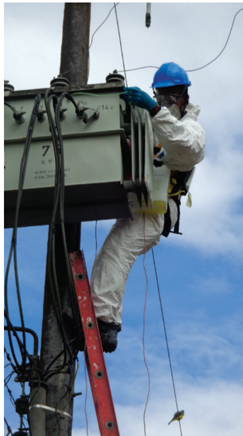
◀ Actividades de diagnóstico de equipos en campo
