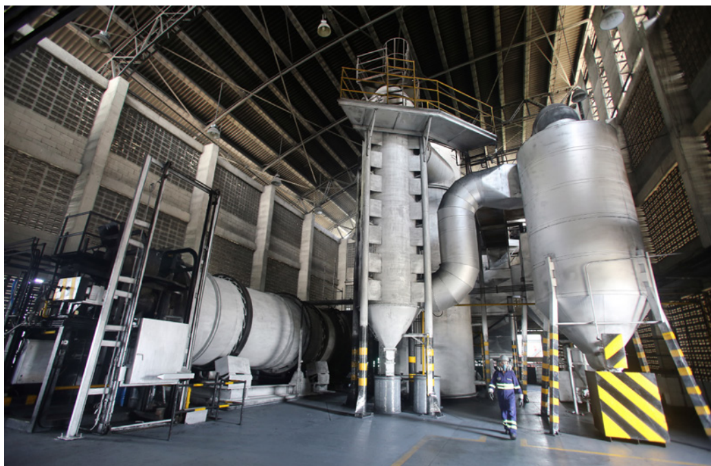
◀ Horno incinerador de residuos peligrosos
