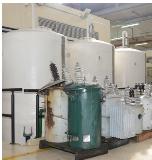
◀ Tanques de almacenamiento de aceite dieléctrico regenerado
